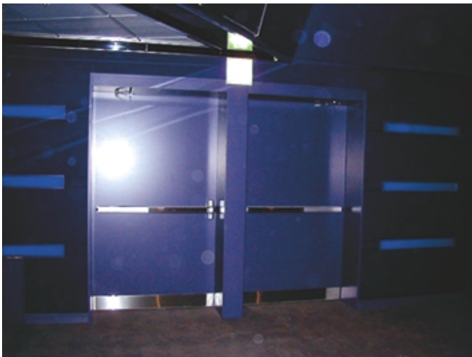
ユニバーサルスタジオジャパン ターミネーター2 高性能防音ドア：FD50(T-5) パニックバー：VD98L(電気ラッチ式)
