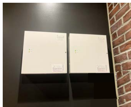
パワーサプライ制御盤
