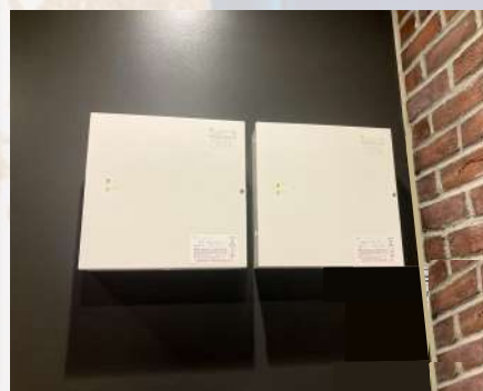
パワーサプライ制御盤
